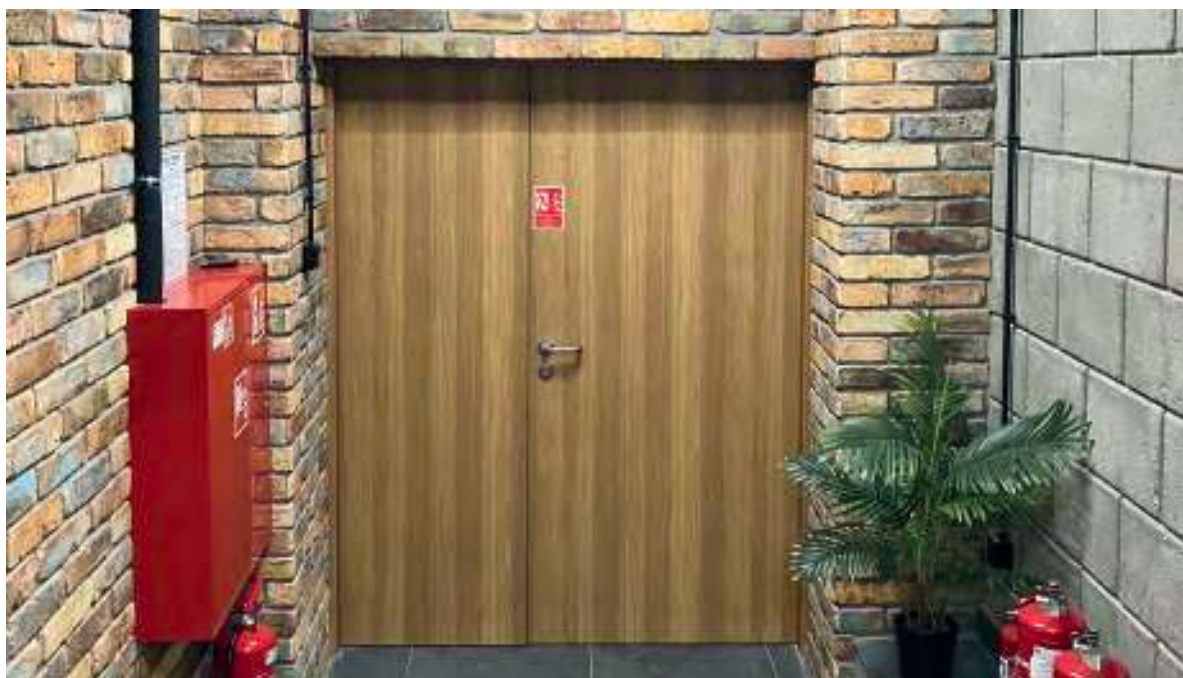
protipožární dveře FR EI30, pevná dřevěná zárubeň
