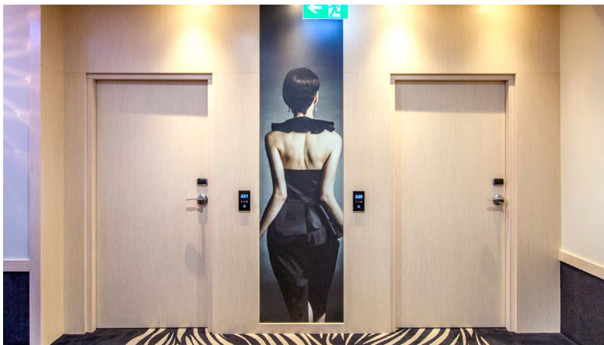
protipožární dveře FR EI30, pevná dřevěná zárubeň
